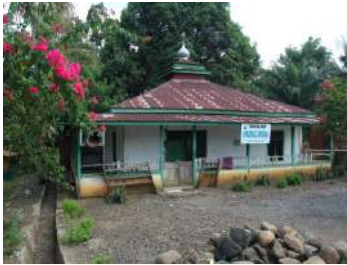
Masjid Nurul Huda (lama) Kondisi bocor dan retak
