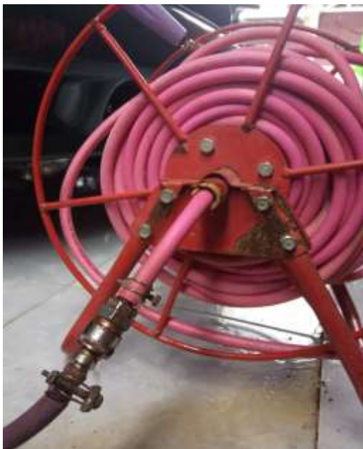
Gambar 5.11 Kerusakan Onderdil Peralatan Penyemprotan
