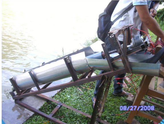
Gambar 5.8 Komponen Terpasang Screw turbin dan Generator
