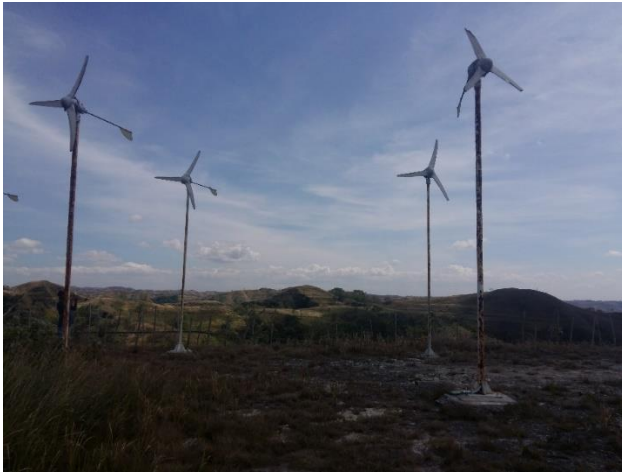
Gambar 1. Kincir Angin untuk Pembangkit Listrik Tenaga Bayu Dusun Kalihi, Desa Kamanggih, Kecamatan Kahunga Eti Sumba Timur
