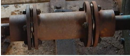
Gambar 12 Alignment pada kopling
