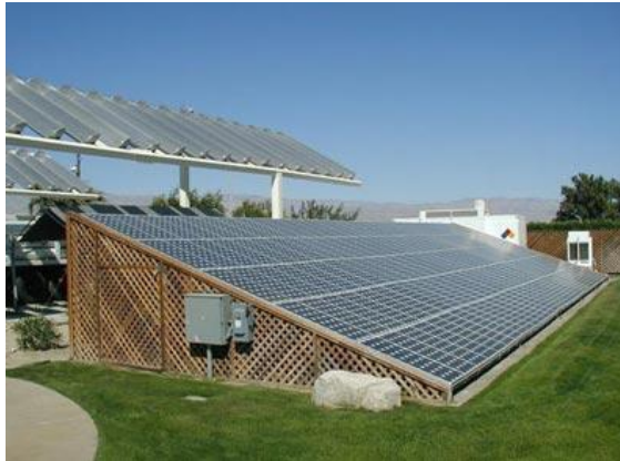
Gambar 2.1 Pembangkit listrik tenaga surya [7]
