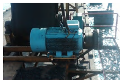
Gambar 20. Motor Penggerak Belt Conveyor
